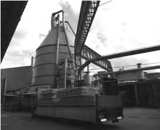
銘建工業の発電用ボイラー
